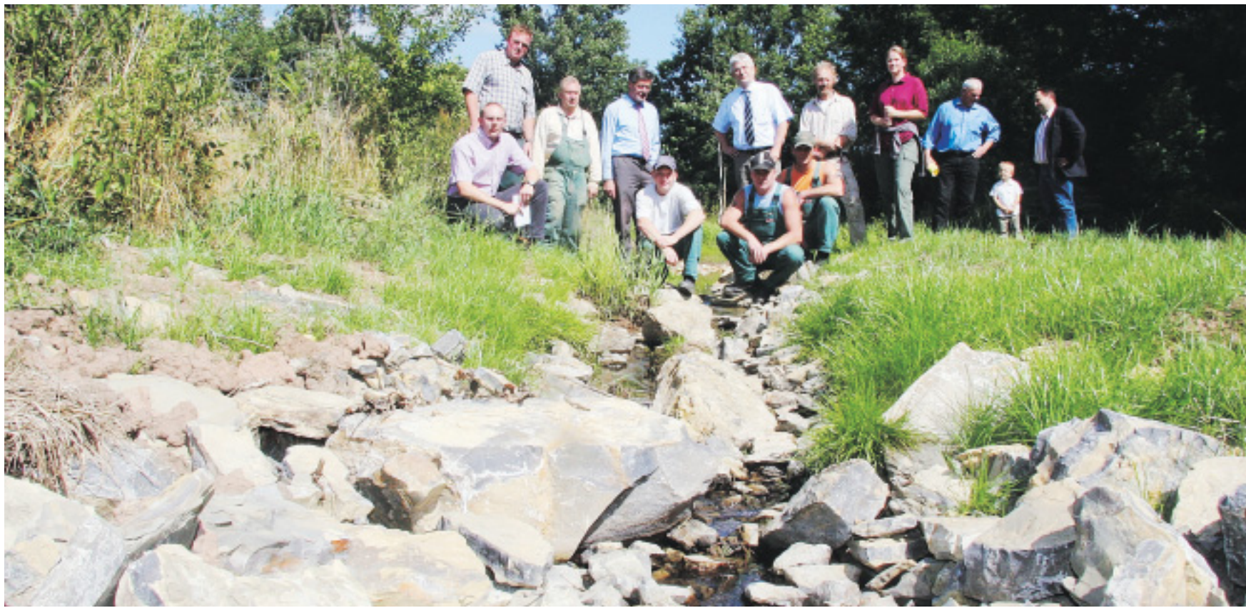
Ganze Arbeit geleistet: Im Rahmen des Beschäftigungsprojektes von Netzwerk, AGA, Kreis und Agentur für Arbeit wurde der Bachlauf in Wilberg erstellt. FOTO: KOCH
