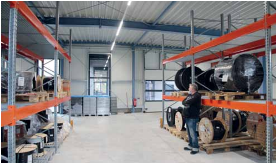
Das neue, großzügig ausgelegte Lager – wie der gesamte Neubau mit Fußbodenheizung
